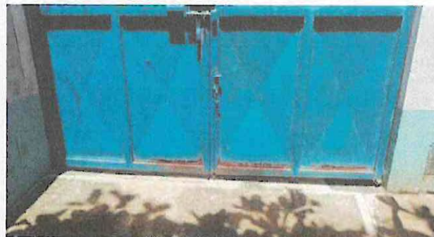
Porton deteriorado parte interna
