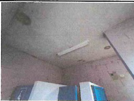
lamparas en mal estado en baño
