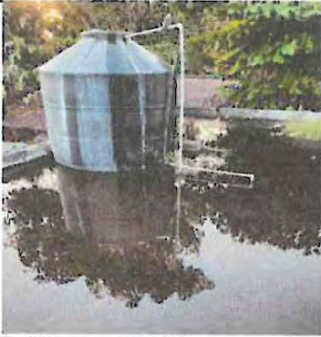
Deposito de agua y losa en mal estado
