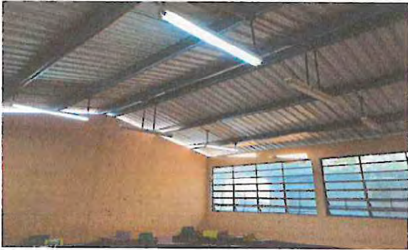
sistema electrico en mal estado
