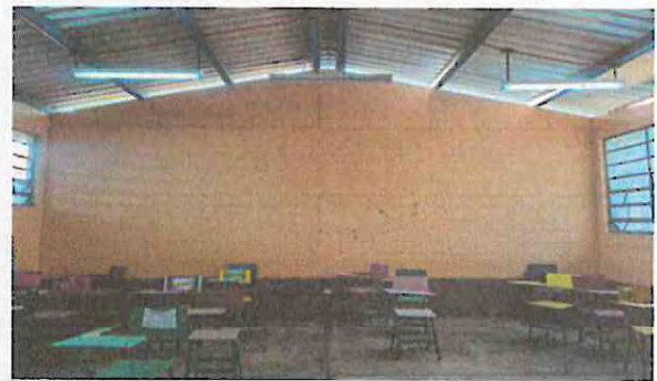
lampara en mal estado en aula
