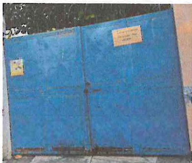
Porton deteriorado por oxido parte frontal
