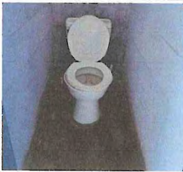
sustitucion de inodoro en mal estado
