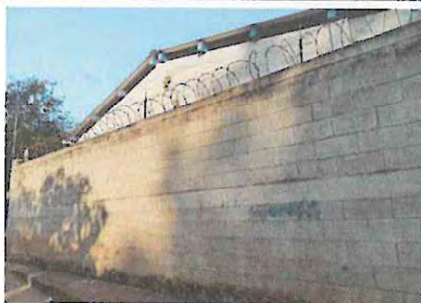
pintura en muro exterior
